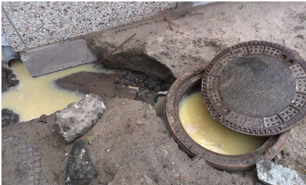
Foto: Verzakking in het rioleringsysteem.
