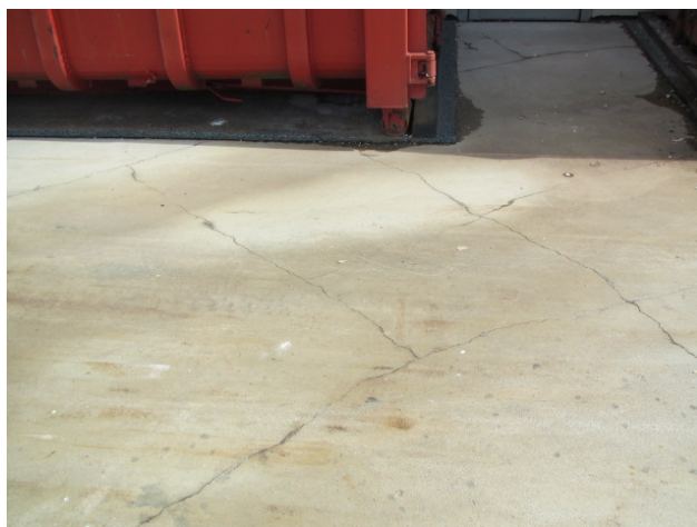
Foto: Voorbeeld niet-vloeistofdichte voorziening (scheuren).
