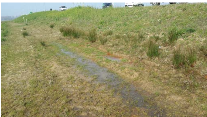
Foto: verzadiging teen talud.
