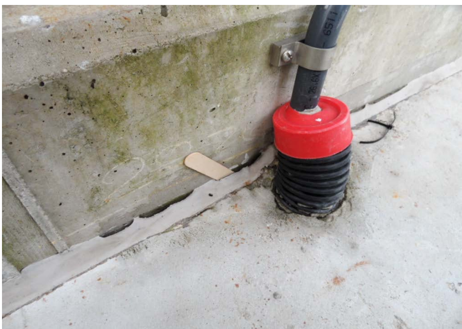
Foto: Gebrek in een afdichting.
