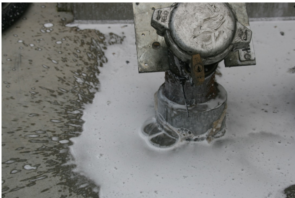
Foto: Luchtlekkage bij doorvoer.
