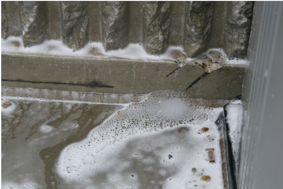
Foto: Luchtlekkage bij aansluiting.
