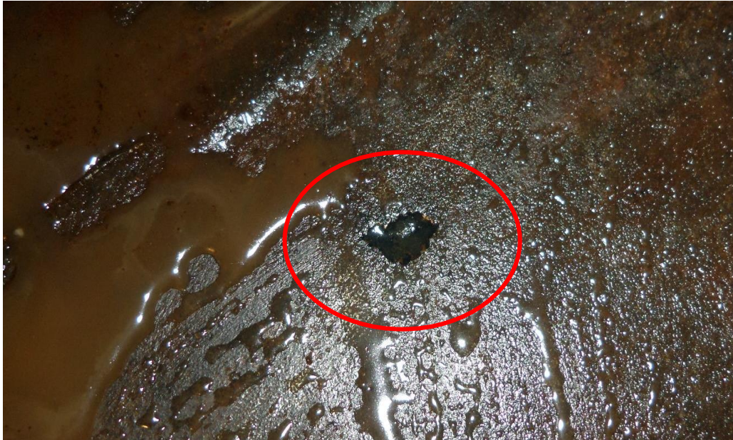
Figuur 5-3: putcorrosie dieseltank 2 Wolvega
