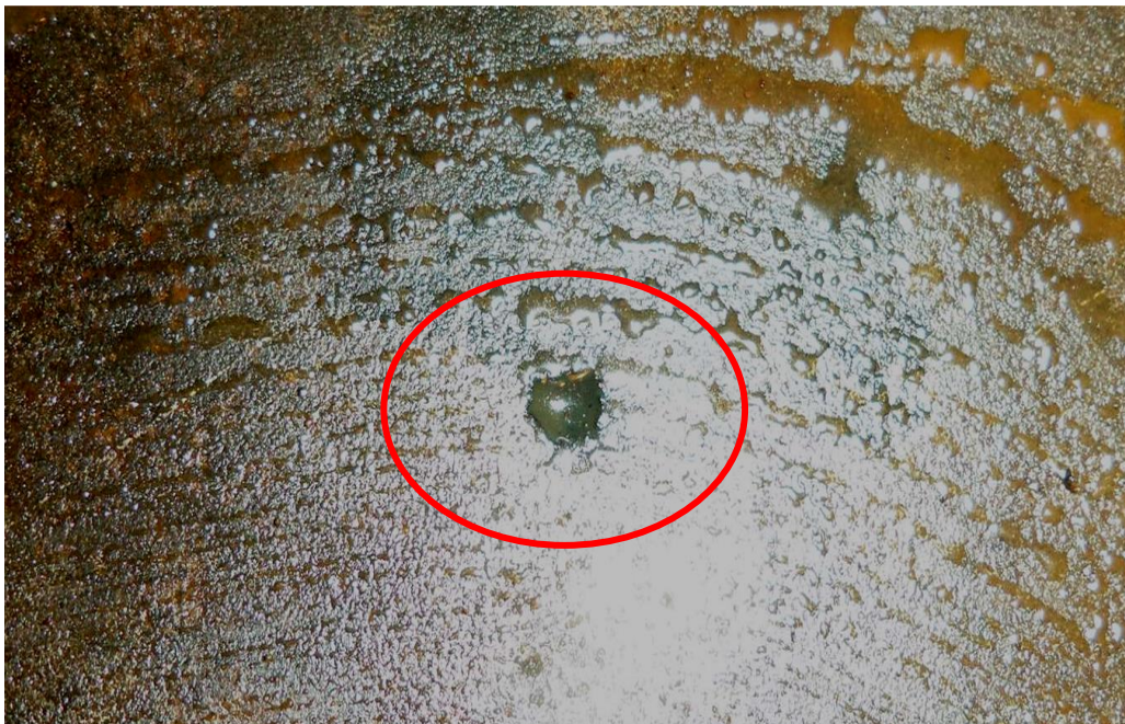
Figuur 5-2: putcorrosie dieseltank 1 Wolvega
