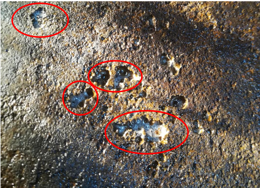
Figuur 5-4: putcorrosie dieseltank Barneveld
