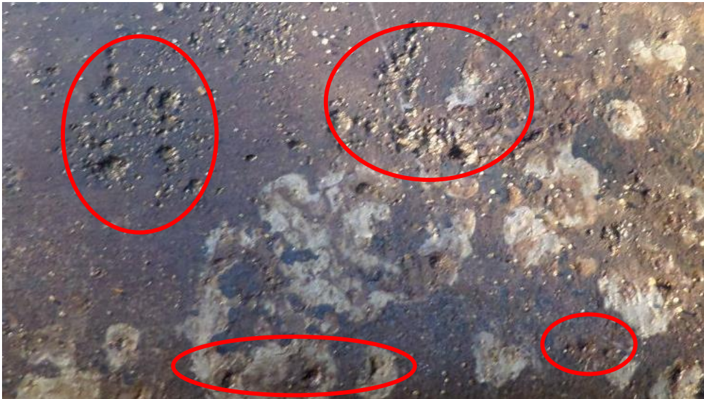
Figuur 5-5: putcorrosie dieseltank Groningen Universiteit
